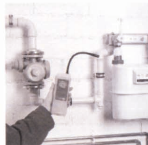
使用testo 316 检漏测量
